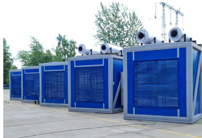
ДЭС Комаровское горное предприятие TSS Mitsubishi TMS 1650 TS
