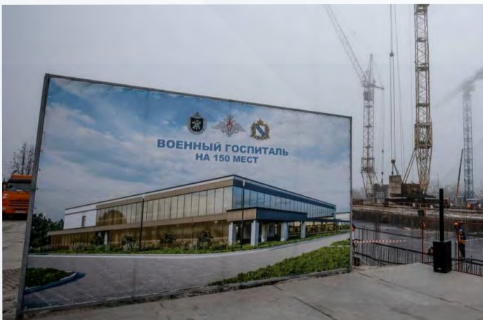
Военный госпиталь г. Курск TSS АД-1000С-Т400-1РНМ9-ПОЖ
